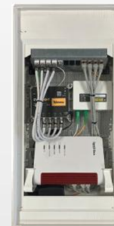
OB4xxx-verbaut im Medienverteilschrank
