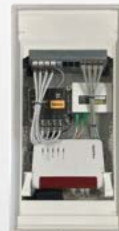
OB4xx-verbaut im Medienverteilschrank
