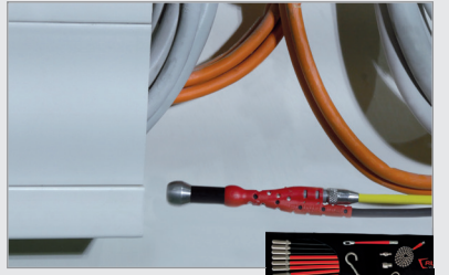
Şaftlar ve zemin altı kanallar
